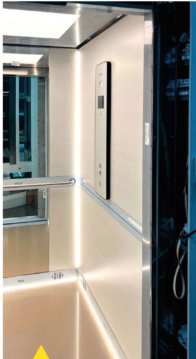
Zargensteuerung und Kabinenausstattung.
